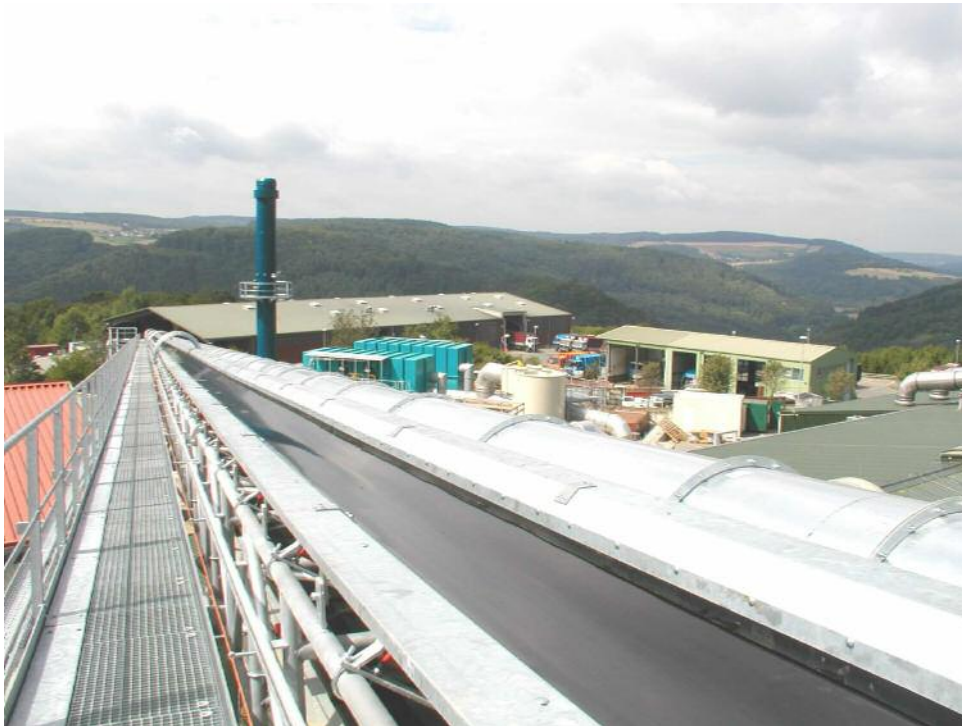
Abbildung 4 Transportband Restabfall MBA Singhofen (noch ohne Abdeckung) Waste conveyor MBT Singhofen
