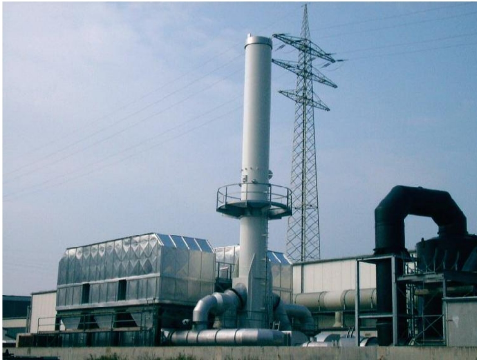
Abbildung 3 Abluftreinigung MBA Linkenbach Exhaust air treatment MBT Linkenbach
